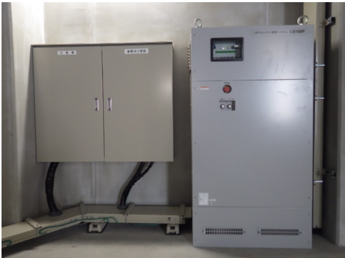
リチウムイオン蓄電池システム (館内)
