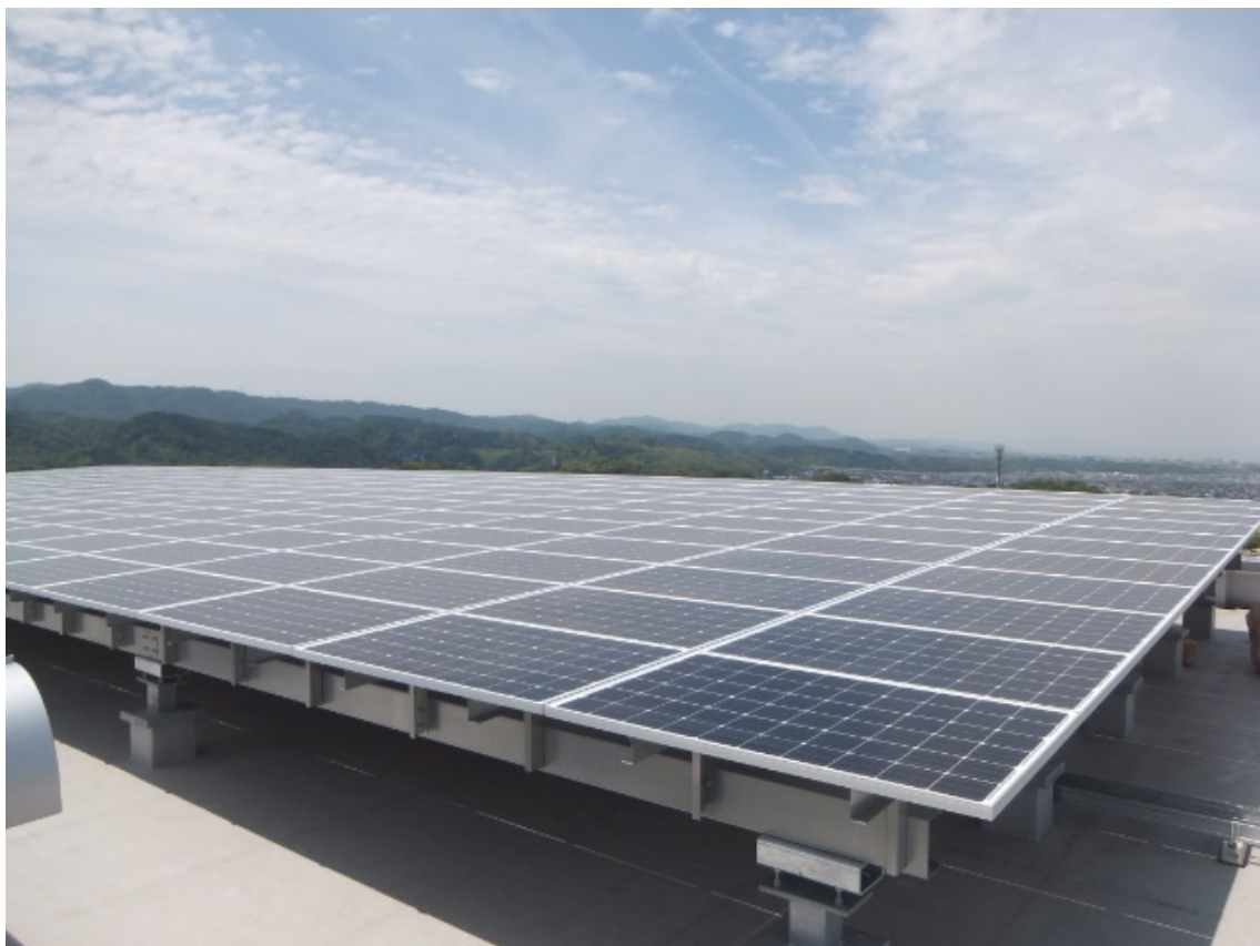
太陽光発電システム（屋上）
